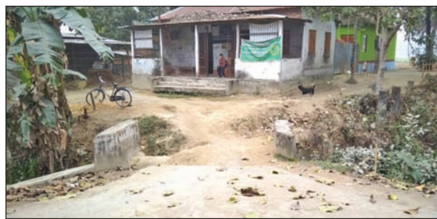
ধূলার্গাও বাজারে থাকা এই উপস্বাস্থ্যকেন্দ্রে ঢোকার মুখে রাস্তাটি ভেঙে রয়েছে।
